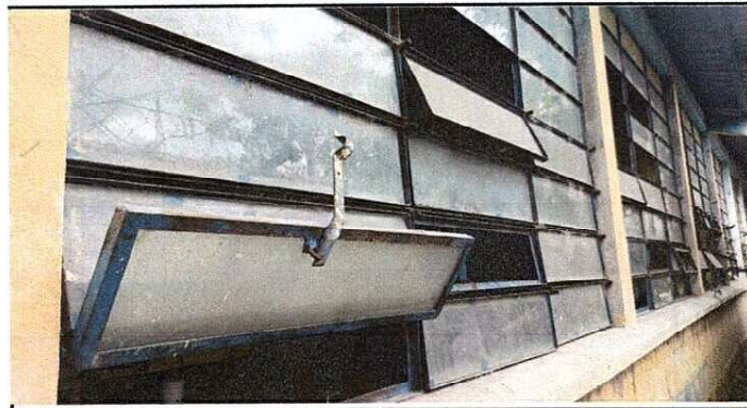
Foto 2: Ventanas en mal estado se sustituirá con ventanas de PCV blanco y se colocará balcones.
