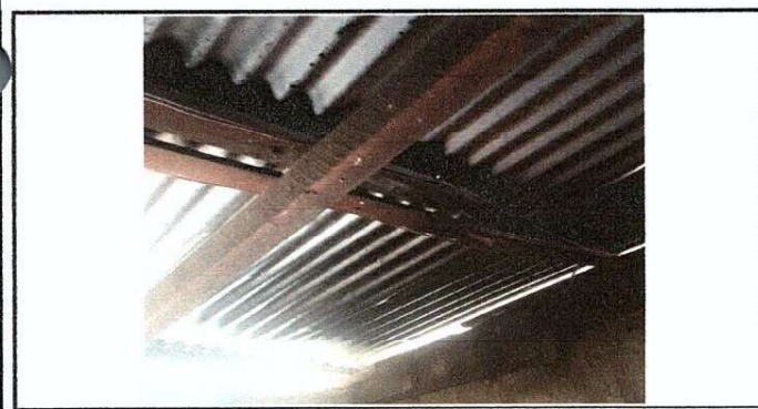
Foto 5: Techo de cocina en mal estado se colocará estructura metálica y lámina calibre 26.
