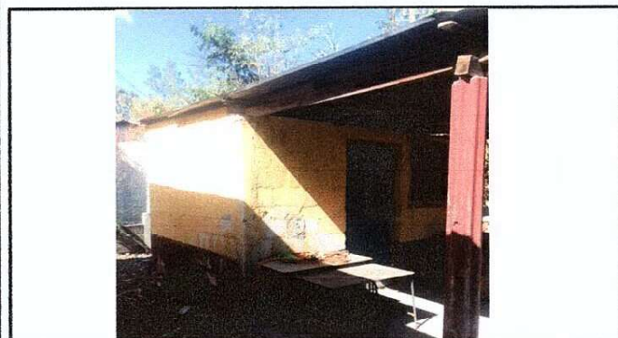
Foto 3: Techo de cocina en mal estado se colocará estructura metálica y lámina calibre 26.
