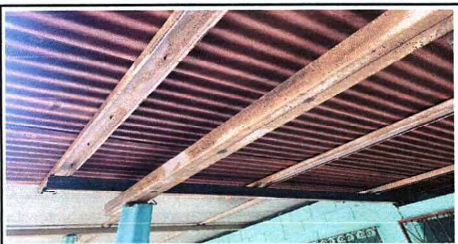
Foto 11: Ampliación de techo en cubierta de lámina
