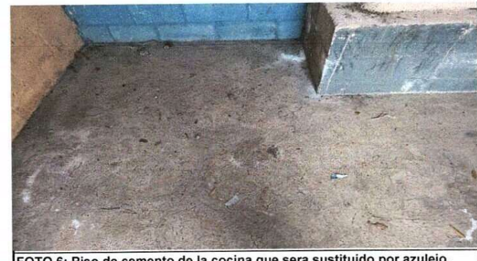
FOTO 6: Piso de cemento de la cocina que será sustituido por azulejo.
