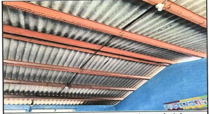
FOTO 2: Interior del techo del aula que se encuentra en mal estado.
