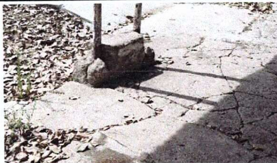
Foto 4: Mejoramiento de galera de ingreso. Losa completamente deteriorada.
