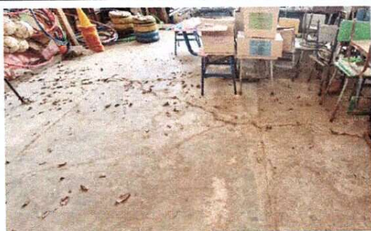
Foto 1: Mejoramiento de dos aulas y dirección, con daños en el piso.
