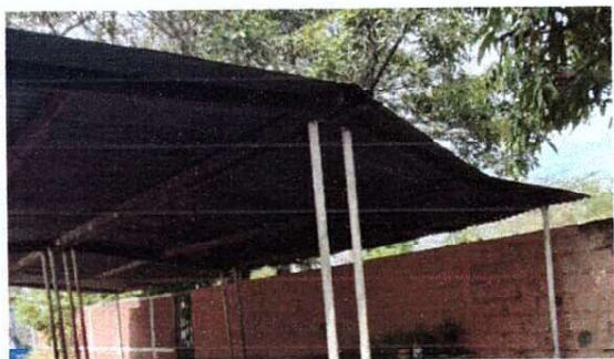
Foto 3: Mejoramiento galera de ingreso. Con avanzado grado de deterioro en el techo y la estructura del techo.
