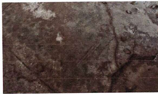
Foto 2: Mejoramiento de dos aulas y dirección, con daños en el piso.
