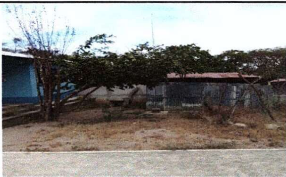
Foto 1: Parte exterior de la cocina que se encuentra en mal estado,
