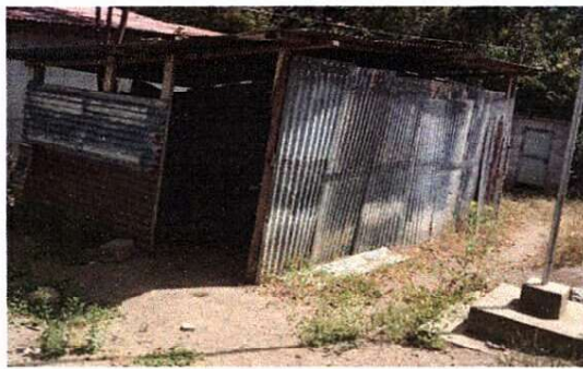
Foto 4: Mejoramiento de las paredes de la cocina en mal estado.
