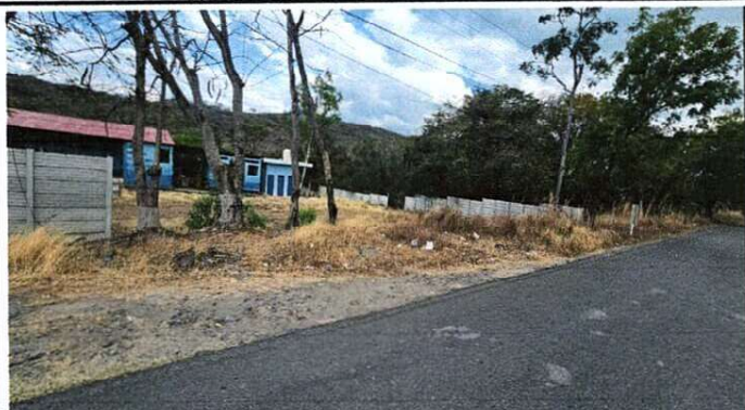
Muro Perimetral: parte vista desde la calle, se le realizará levantado de la parte que sufrió daños.
