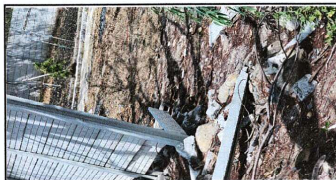
Columna Derribada de la parte de adentro.
