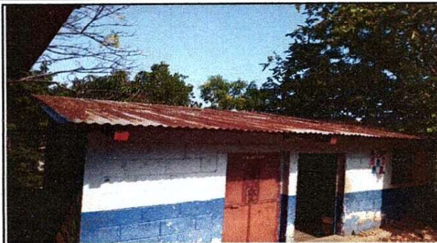
Foto 2: Se cambiará el techo (lámina) de la cocina y mantenimiento de puerta.
