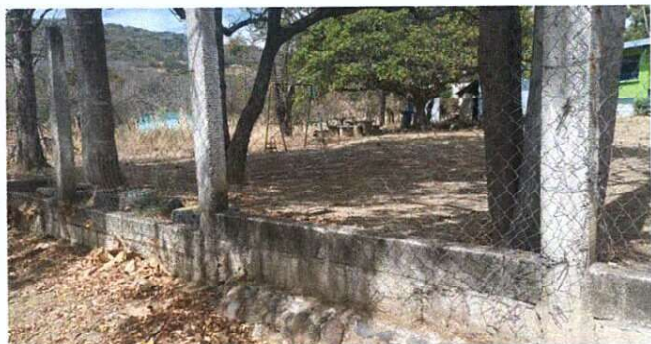
Foto1: Se necesita sustituir la malla en mal estado.
