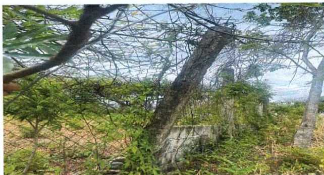
Foto 4: Es necesario sustituir columnas y el mejoramiento del muro con block en una parte para mayor seguridad en el establecimiento.
