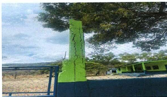
Foto 3: Se necesita sustituir varias columnas en mal estado.
