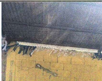
Foto 1: Sistema eléctrico. Mejoramiento del sistema eléctrico.
