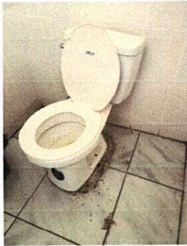
Foto 1: cambio de baño por deterioro
