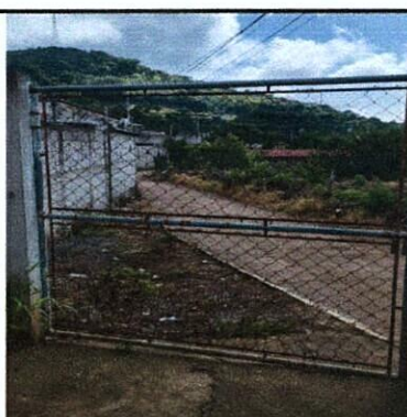
Foto 4: sustitución de porton por deterioro
