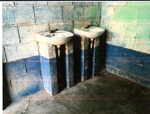
Foto 2: Sustrucción de lavamanos en mal estado
