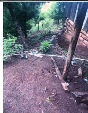
Foto 4: Tubería de Instalacion de agua potable.
