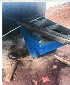
Foto 5: Tubería de Instalacion de agua potable para pila exterior.
