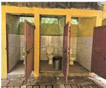
Foto 5: Sustrucción de tasas de sanitarios
