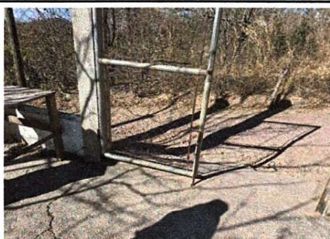
Foto 4: PORTÓN EXISTENTE QUE REQUIERE REPARACION Y MANTENIMIENTO
