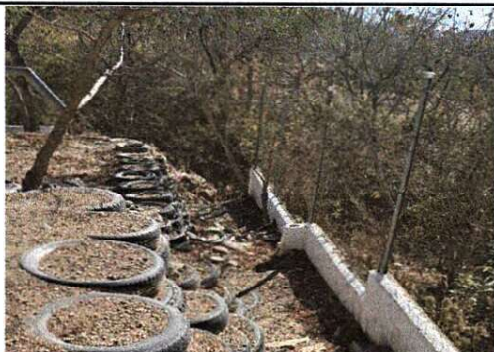
Foto1: AREA AFECTADA DONDE SE REQUIERE UN MURO DE CONTENCIÓN
