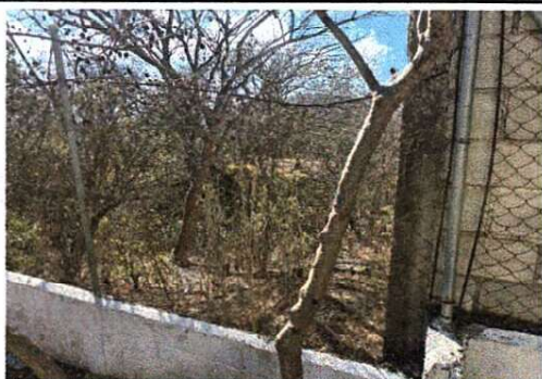
Foto 3: MALLA PERIMETRAL EN MAL ESTADO
