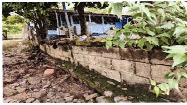
Foto 2: Muro perimetral que se encuentra en mal estado.
