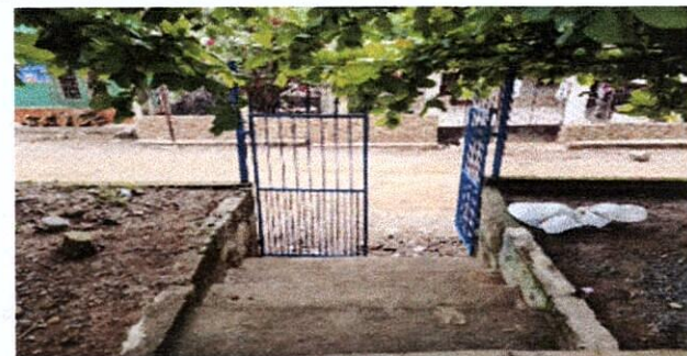
Foto 5: Torta de concreto en gradas de la entrada a la escuela.
