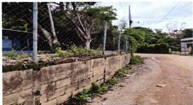
Foto 1: Parte frontal del muro perimetral que se encuentra en mal estado.
