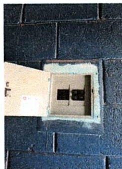
El sistema electrico necesita ser renovado
