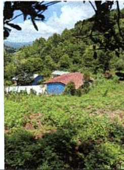
El techo de las aulas del módulo principal esta oxidado
