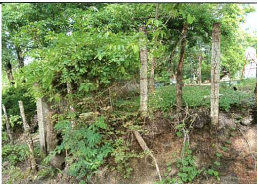
FOTO 1 MURO PERIMETRAL DAÑADO
