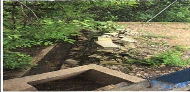
FOTO 2: MANTENIMIENTO A CAJA DE REGISTRO
