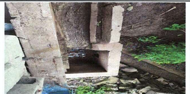
FOTO 5: MANTENIMIENTO A CAJA DE REGISTRO
