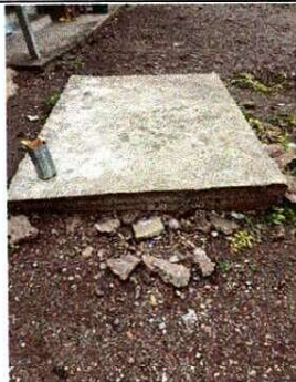
FOSA SEPTICA REBALSANDO
