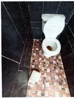
SANITARIOS EN MAL ESTADO Y TUBERIA TAPADA
