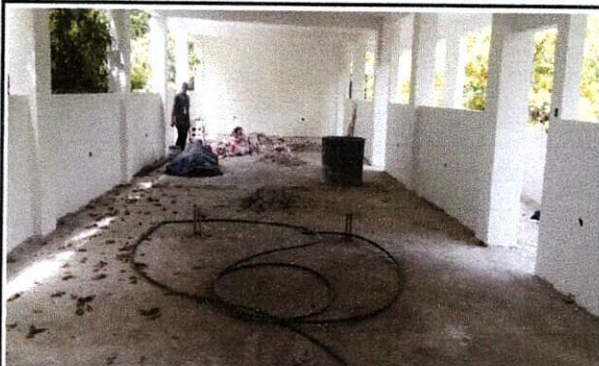
TORTA DE CEMENTO RÚSTICA CON PUNTAS DE HIERRO EXPUESTAS
