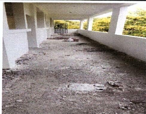
CORREDOR CON GRETADURAS Y DESNIVEL
