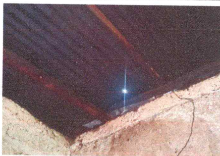
Foto 1: Cubierta de lamina con grietas y en estado inservible.
