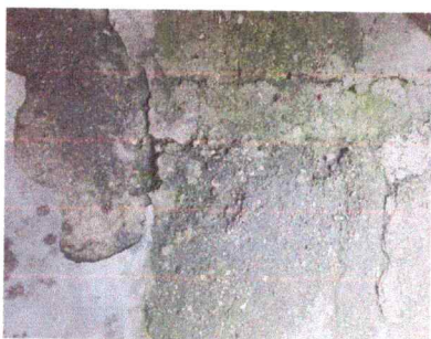
Foto 3: Losa con ritas y desniveles por desgaste.
