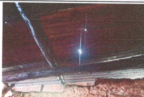
Foto 2: estructura de techo en mas estado casi en su totalidad
