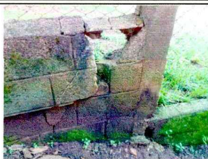
Foto 2: Se observa muro en mal estado
