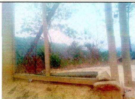
Foto 1: Se observa porton en mal estado
