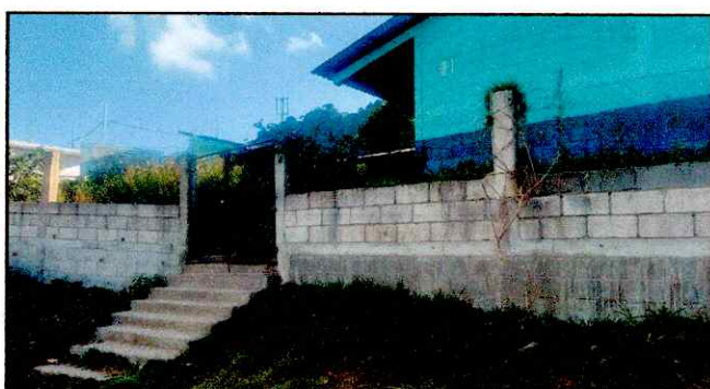
Foto 10: Pinturas en muros interior y exterior. Aplicar pintura azul y/o celeste para rejuvenecer áreas sin pintar o con escasa pintura.
