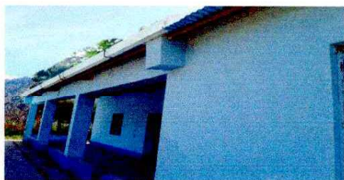
Foto 3: Canales deteriorados por antigüedad.
