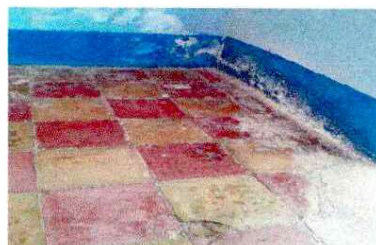
Foto 2: Piso de una de las aulas con alto grado de deterioro por antigüedad.
