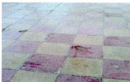
Foto1: Piso de aulas, bodega y corredor con deterioro por antigüedad.
