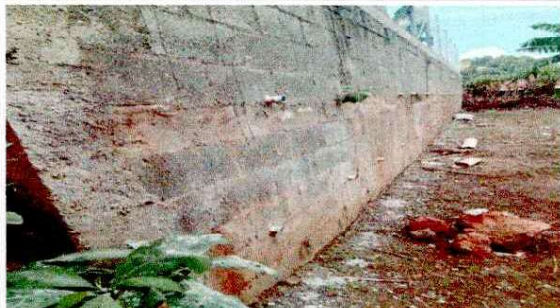
Foto 1: MURO DE CONTENCIÓN DESPLOMADO POR SER RELLENO.
