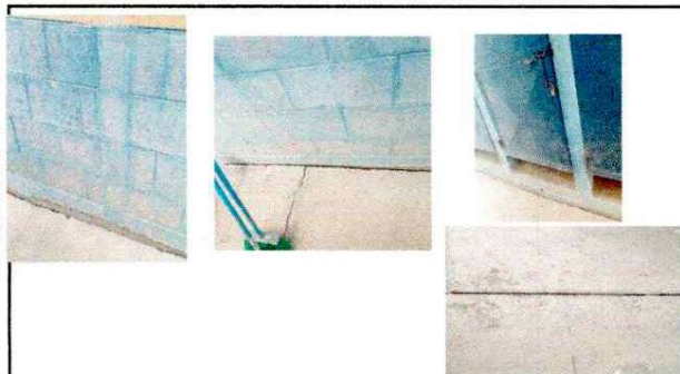
Foto 3: LOSA DE PATIO EN DETERIORO.
