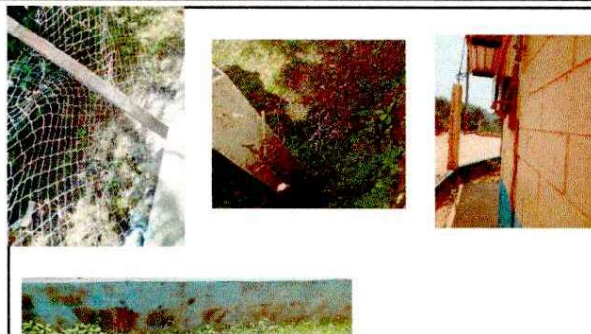
Foto 2: MURO PERIMETRAL EN DETERIORO.
