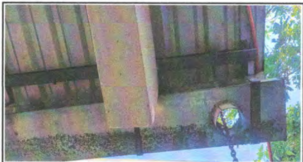
Foto 4: Canales en mal estado
