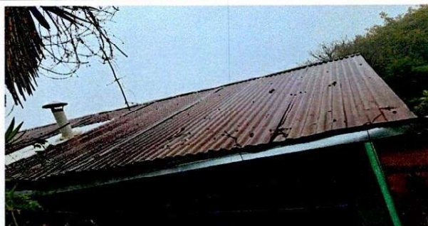
Foto 2: Requiere cambio de canales ya que estan en mal estado
