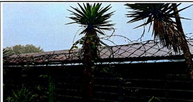
Foto 3: El muro perimetral se encuentra en mal estado.
