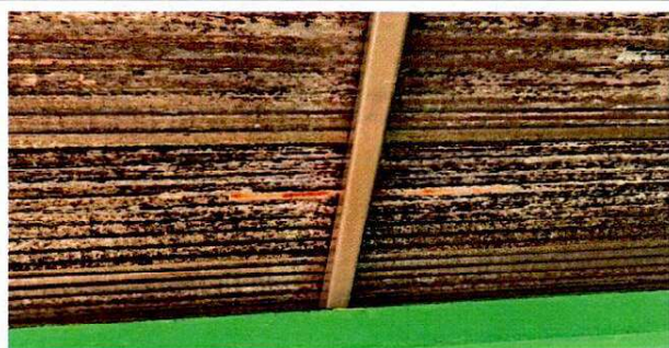
Foto1: Se evidencia necesidad de cambio de cubierta ya que la lamina esta en muy mal estado
