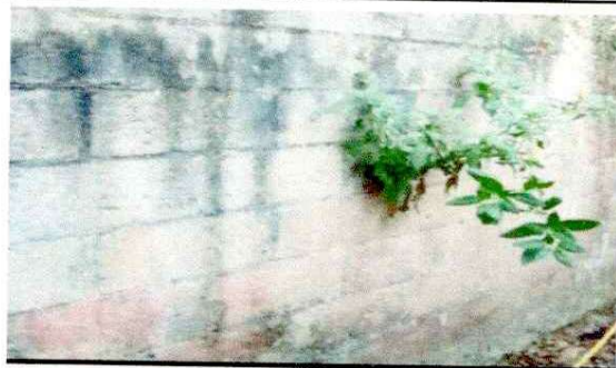
Foto 3: Pintura en mal estado
