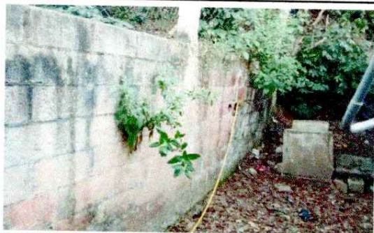
Foto1: Muro Perimetral en mal Estado
