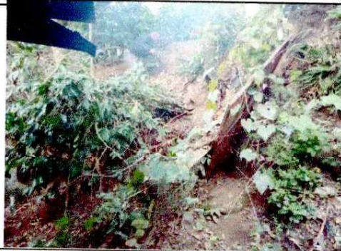
Foto 2: Muro Perimetral en mal Estado
