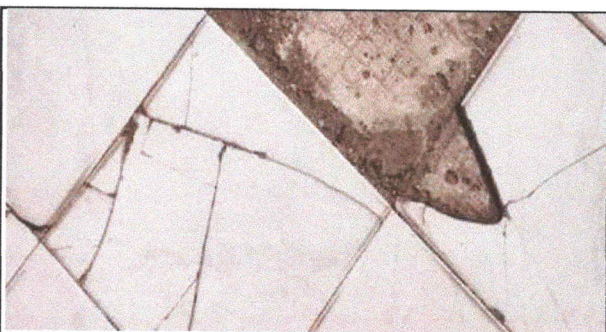
Foto 3: SE OBSERVA PISO CERAMICO EN MAL ESTADO
