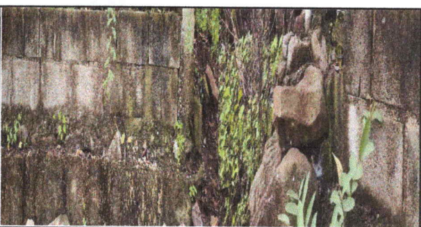
Foto 5: ES NECESARIO LA SUSTITUCION DE MURO PERIMETRAL
