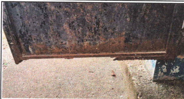
Foto 1: PUERTA DE METAL EN MALAS CONDICIONES
