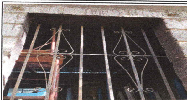
Foto 2: ES NECESARIO LA SUSTITUCION DE VENTANAS DE METAL
