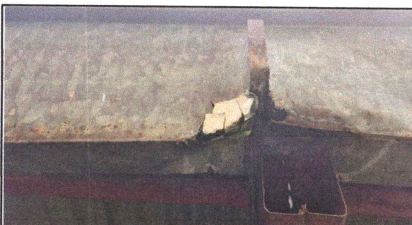
Foto 4: CANAL EN PESIMAS CONDICIONES
