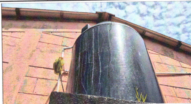
Foto 2: DEPOSITO DE AGUA SE OBSERVA EN MALAS CONDICIONES YA QUE SE FILTRA EL AGUA DEBIDO A QUE TIENE RAJADURAS EN SU CONTORNO
