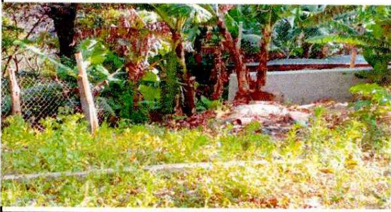
Foto 1: En las fotografías se aprecia la necesidad de reparación de muro perimetral para evitar cualquier riesgo para los estudiantes del nivel preprimaria y primario..
