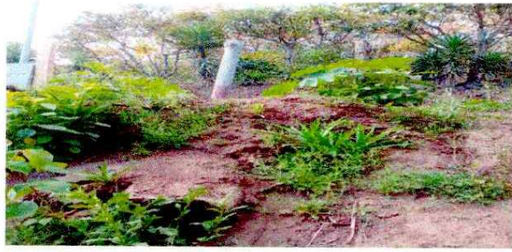
Foto 3: En esta fotografía se puede apreciar la necesidad de reparación de muro perimetral.
