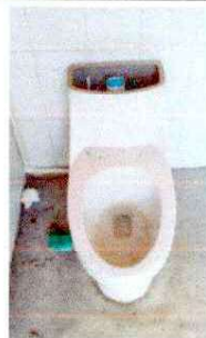
Foto 6: SERVICIOS DE SANITARIOS Y ACCESORIOS.
