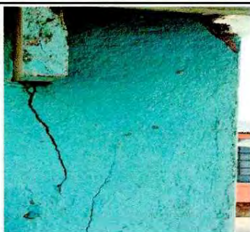
Foto 5: PARED EXTERIOR DE AULA 2
