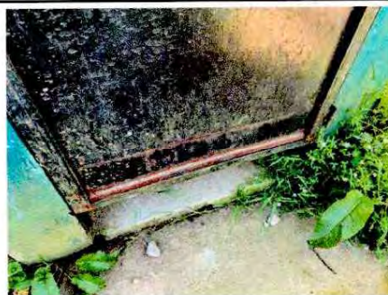
Foto 4: PUERTA EN ÁREA DE BAÑOS
