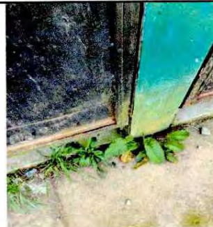
Foto 6: PUERTA EN ÁREA DE BAÑOS
