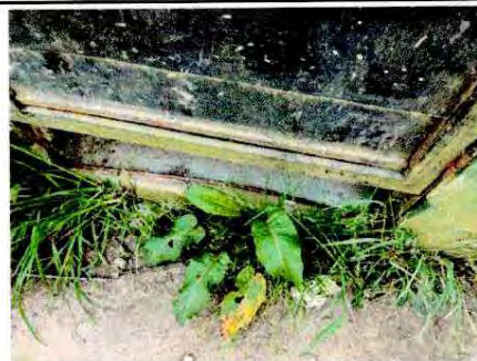
Foto 2: PUERTAS EN ÁREA DE BAÑOS
