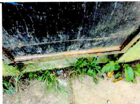
Foto 5: PUERTA EN ÁREA DE BAÑOS
