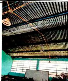
Foto 2: ÁREA ELÉCTRICA DE AULA 3
