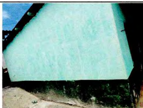
Foto 4: PARED EXTERIOR DE AULA 1
