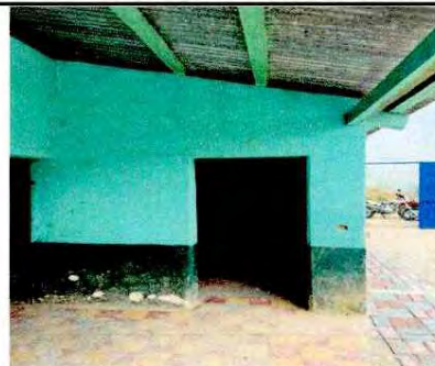
Foto 2: PARED EXTERIOR DE AULA 2
