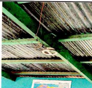
Foto 4: ÁREA ELÉCTRICA DE AULA 1
