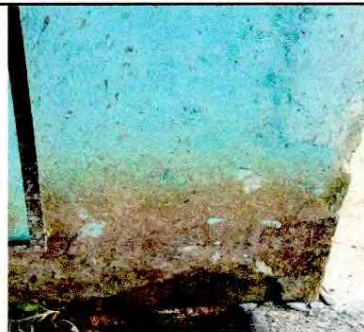
Foto 6: PARED EXTERIOR DE AULA 1
