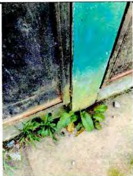
Foto 3: PUERTA EN ÁREA DE BAÑOS
