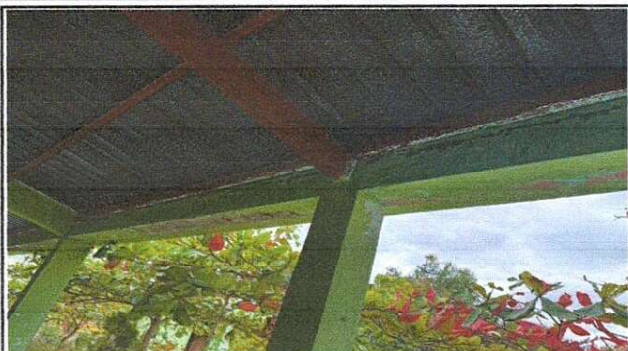
Foto1: Canales en mal estado.
