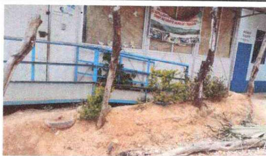
Foto 1: SE APRECIA EL ESTADO DEL CERCO QUE DA A LA CALLE
