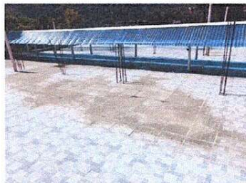
Foto1: Espacios donde el agua se estanca y es necesario realizar impermeabilización. 5 espacios.
