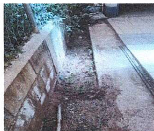
Foto 4: Cuneta de tierra, necesario sustituirla porque en invierno se forma demasiado fango.
