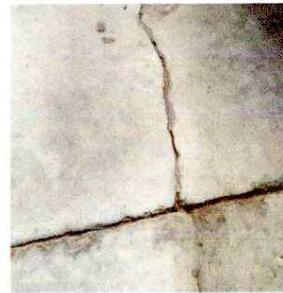
Foto 4: Estado actual de piso
