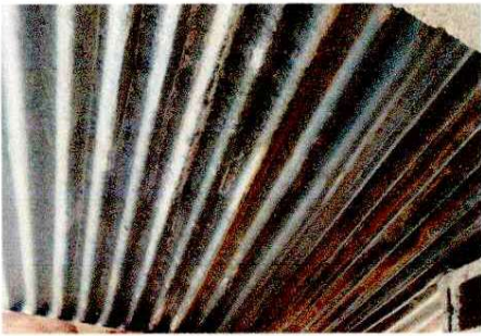
Foto1: Estado actual de lámina
