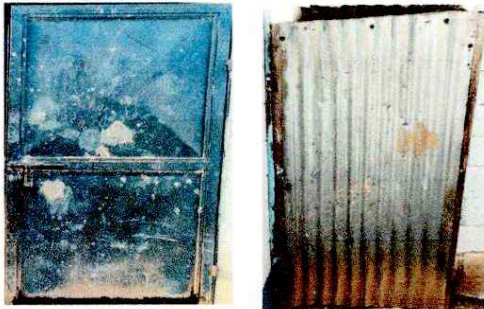
Foto 3: Puertas de aulas y baño destruido
