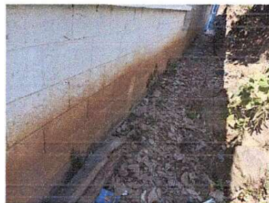
Foto 2: Paredes con exceso de humedad
