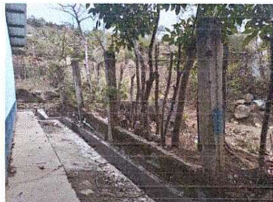
Foto 1: Muro perimetral dañado
