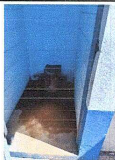
Foto 4: Sanitarios en mal estado
