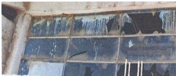
Foto 2: Se cambiarán los ventales ya que están quebrados
