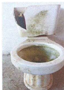
Foto 4: Se cambiarán los sanitario ya que los actuales están quebrados
