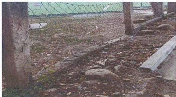
Foto 5: Se cambiará el cerco ya que está en mal estado
