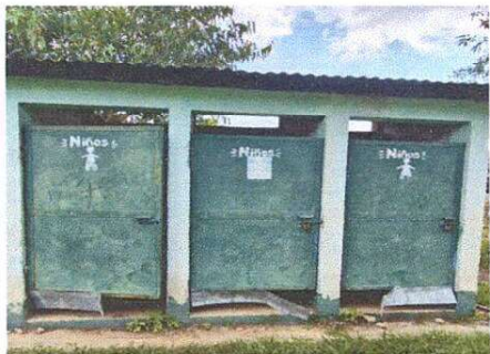
Foto 1: Se repararán las puertas porque está en mal estado
