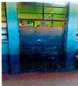
Foto1: Sustrucion de puerta de aula.
