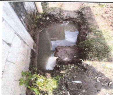
Foto 3: Red de drenaje y fosa septica
