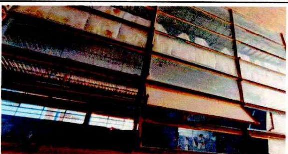
Foto 5: La ventana se encuentra en mal estado.
