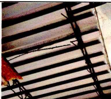
Foto 3: La estructura del techo con cuenta el aula actualmente es de Joist los cuales ya se encuentran en mal estado.
