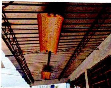
Foto 7: El sistema electrico actual es inservible.
