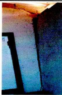
Foto 6: La Pared se encuentra en mal estado y representa un peligro.
