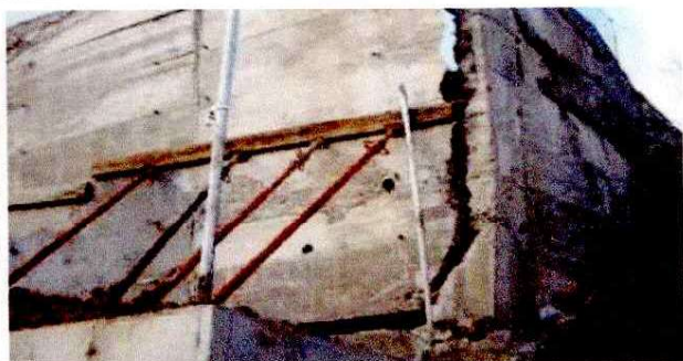
Foto1: se puede identificar el mal estado en que se encuentra el muro de contencion, por lo que provoca peligro para los niños en la escuela
