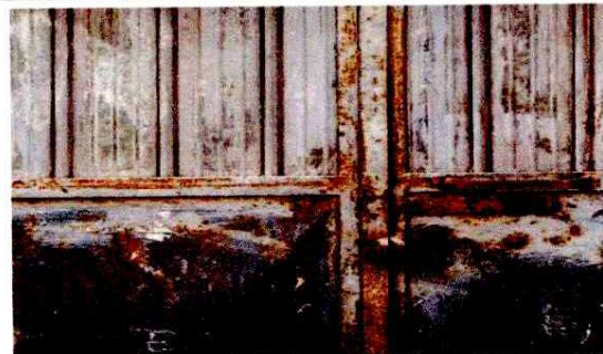
Foto 4: hay partes del porton que necesitan sustituir por la cantidad de oxido que tienen.
