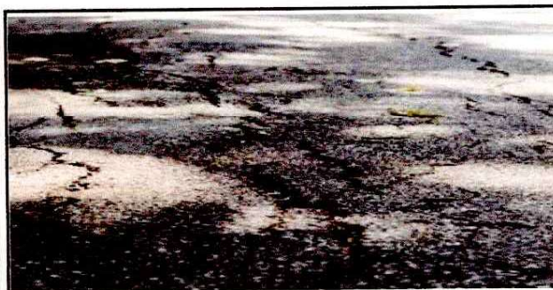
Foto 5: Losa de patio en mal estado.
