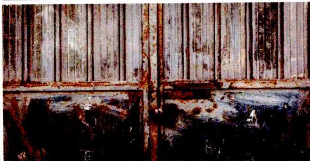
Foto 2: Mantenimiento del porton del centro educativo se encuentra en mal estado, esta oxidado y desgastado.
