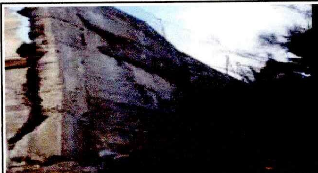
Reparacion del muro de contencion por el mal estado en que se encuentra.
