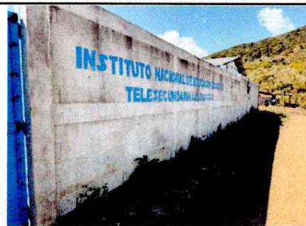
Foto 3: Pintura de muros interno y externo necesitan mantenimiento.
