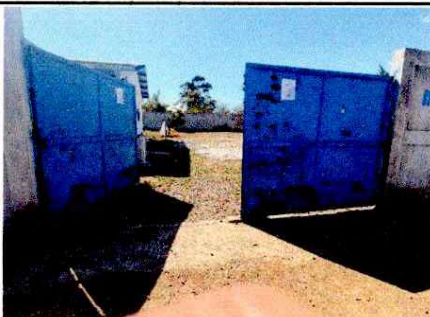
Foto 4: El porton principal necesita reparación.
