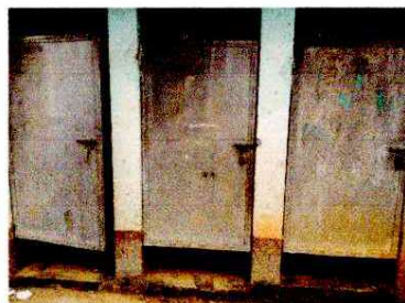
Foto 4: las puertas de los baños se encuentran en mal estado, por lo que es necesario su reparación.
