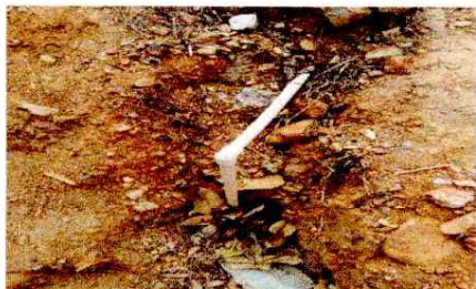
Foto 7: la red de agua potable se encuentra colapsada siendo de vital importancia la sustitucion de la misma para mantener la higiene de los alumnos.
