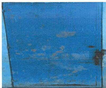
Foto 1: Estado actual de de puertas de aula
