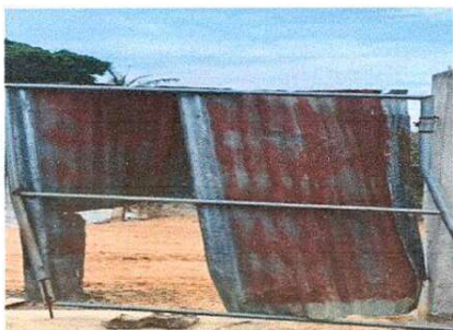
Foto 3: Porton totalmente destruido
