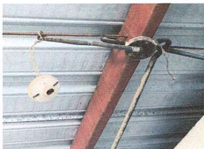
Foto 7: Estado actual de energía eléctrica
