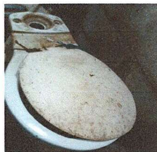
Foto 2: Sanitarios en mal estado
