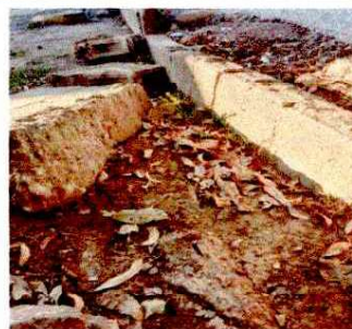
Foto 6: Se cambiará el muro de contención ya que colapsó
