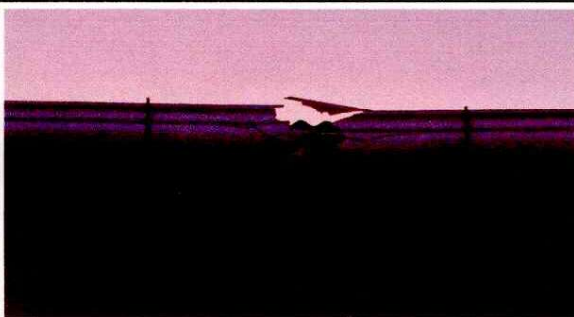
Foto 3: Se cambiará el canal ya que está quebrado
