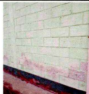
Foto 4: Se pintarán ya que la pintura está deteriorada
