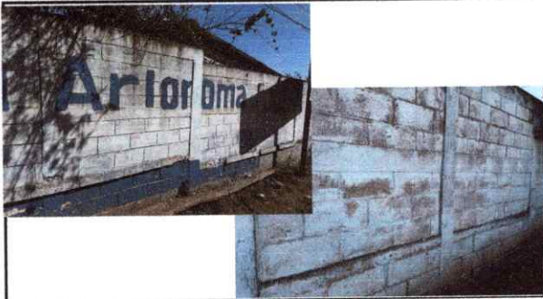
Foto 1: Pintura en malas condiciones
