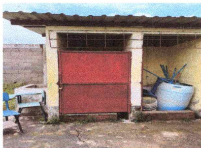
Foto 1: SUSTICION DE PUERTA DE BAÑO (0.80*1.00cms)
